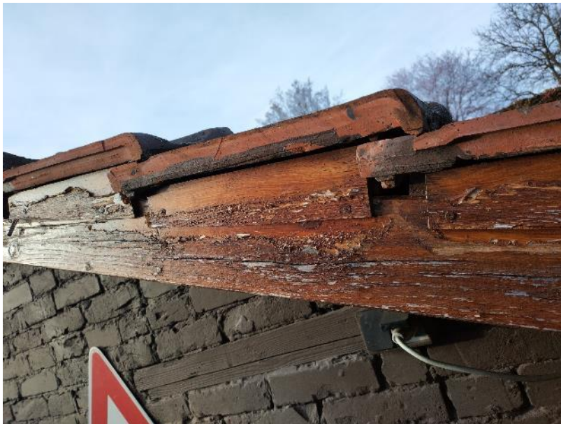
Abbildung 14 Spalten und Löcher in der Gartenhütte
